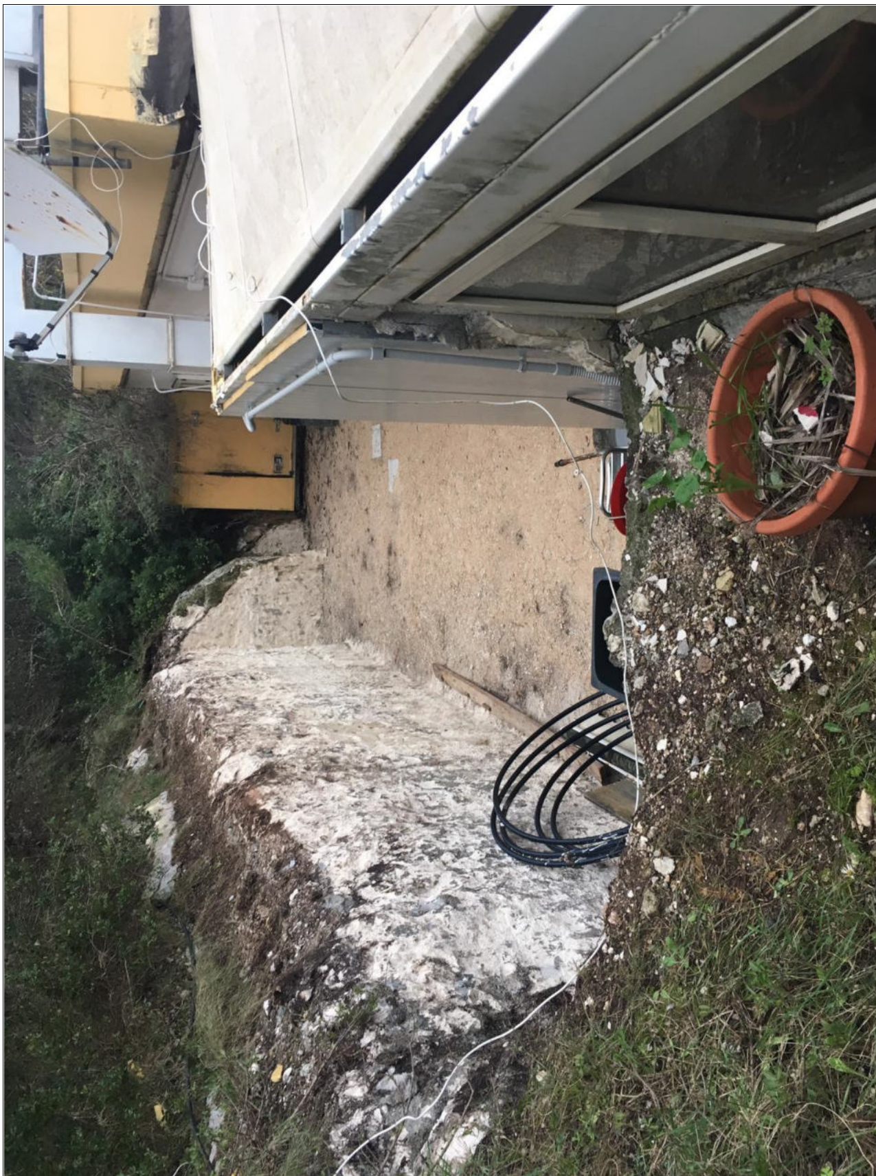
34 - Otranto Porto Badisco, il costone roccioso sbancato in data da accertare sul retro dell'immobile commerciale "Bar L'approdo di Enea Ristorante" ricadente nelle particelle catastali 206 e 272 (foglio 66).
