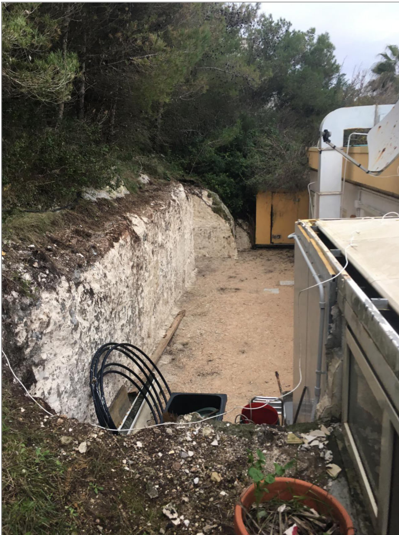
35 - Otranto Porto Badisco, il costone roccioso ricadente nelle particelle catastali 206 e 272 (foglio 66) sbancato in data da accertare sul retro dell'immobile commerciale "Bar L'approdo di Enea Ristorante".
