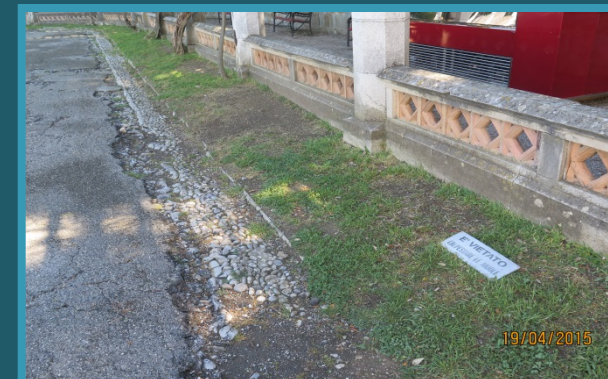
Aiola e fondo stradale in abbandono da anni (aprile 2015).
