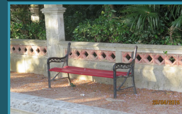
Una delle panchine rotte non riparate (aprile 2015).
