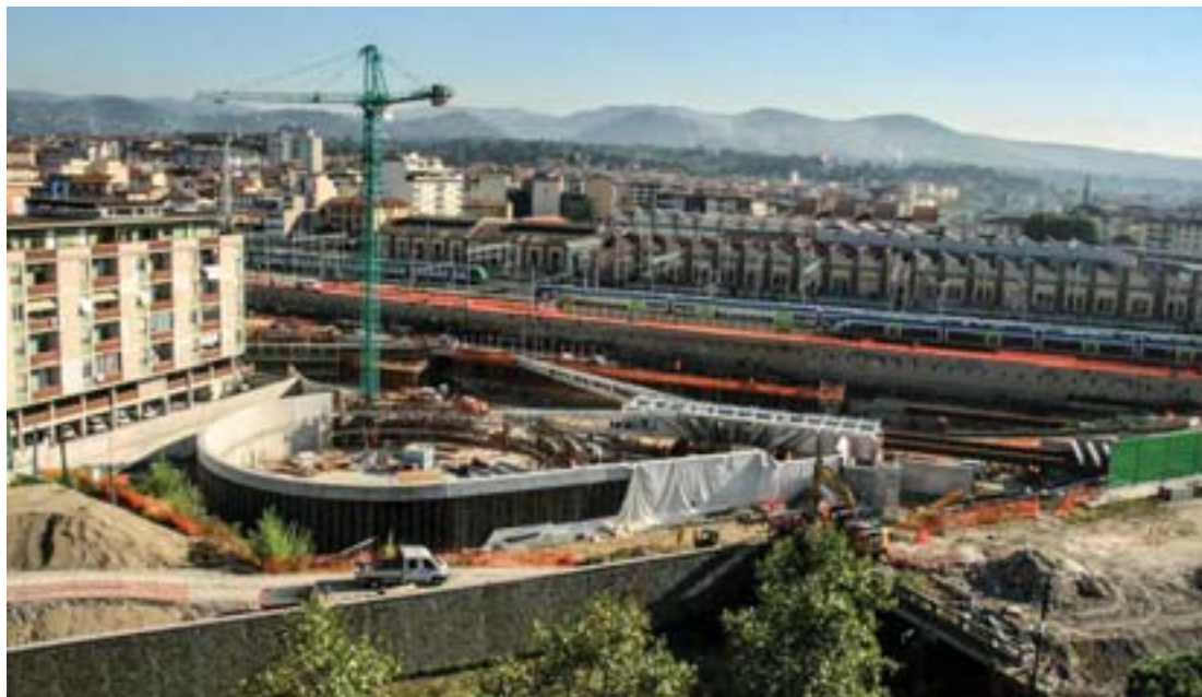
Cantiere per la stazione Foster a Firenze, inquadratura in particolare sulla rampa "kiss and ride" sul lato rivolto verso il Mugnone. Foto di Tiziano Cardosi
