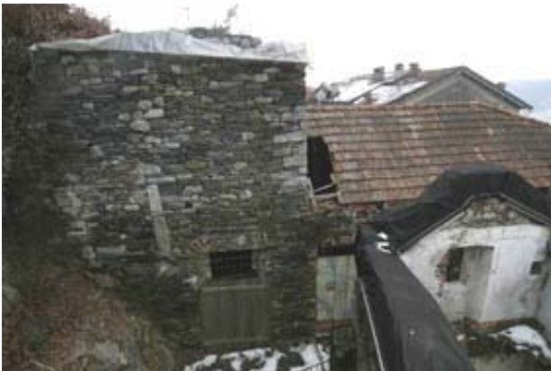
15. Uno degli edifici tardomedievali appartenenti al complesso detto "della Bifora", caratterizzato da paramenti in pietra a vista del sec. XII e anch'esso lasciato degradare. Nella muratura è visibile la spalla destra di un portale incompleto e tamponato.
