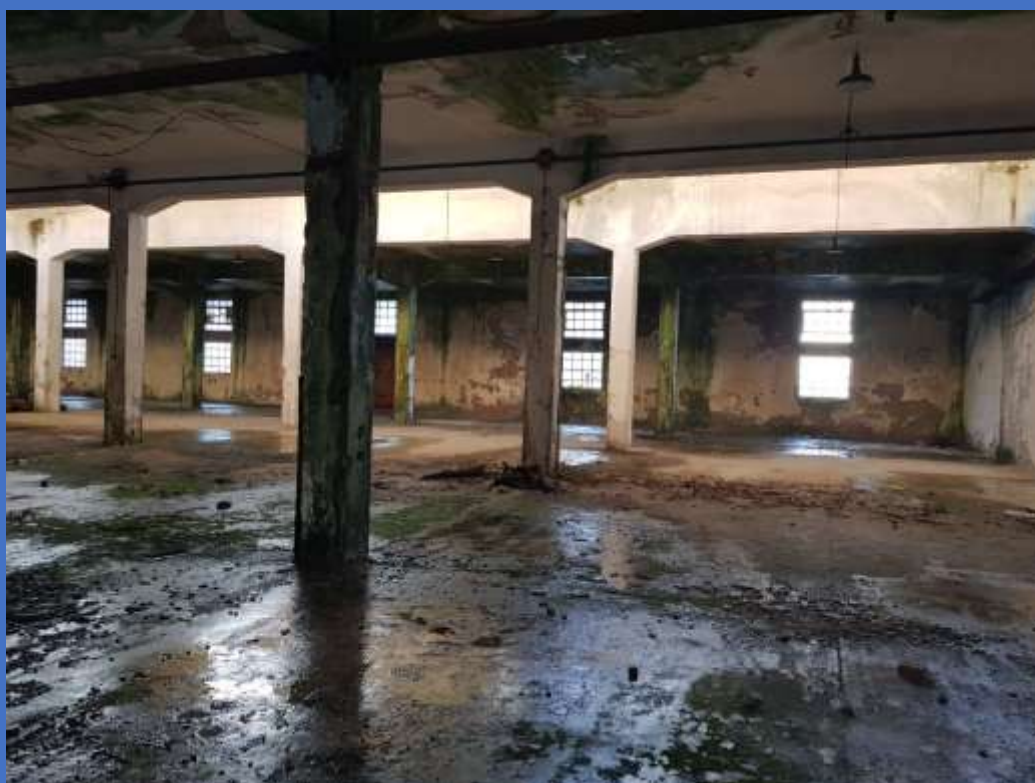
In questa immagine sono evidenti le infiltrazioni a causa della mancanza della falda esterna su parte della copertura, con una netta separazione dalla parte ancora sana.
