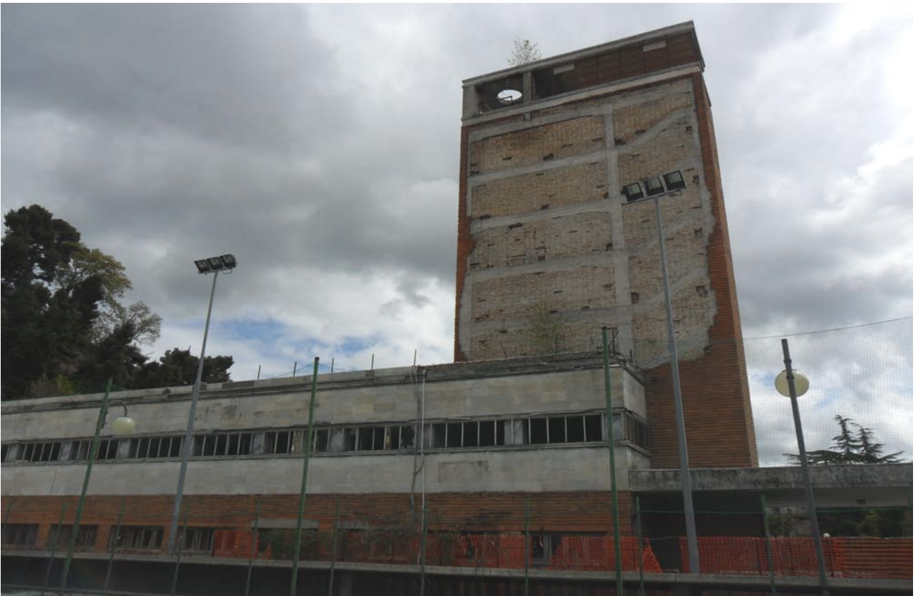
La torre dell'Ex- Gil in condizione di degrado
