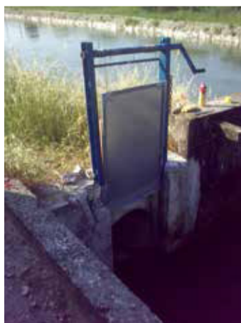
Fig. 49 - Paratoia di scarico, Foto da: www.cic.cr.it (per cortese concessione di Stefano Giovanni Loffi)
