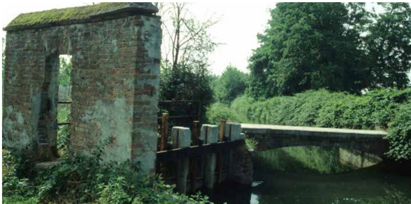
Fig. 48 - Chiusa della roggia Senazzone dalla roggia Alchina a Ombriano, quartiere suburbano di Crema, Foto di Valerio Ferrari
